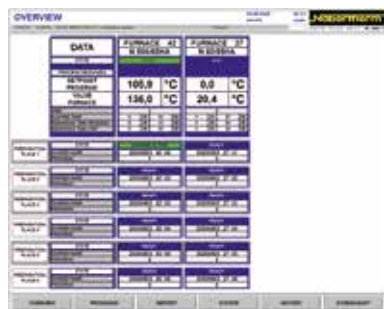
Vista general de la instalación
