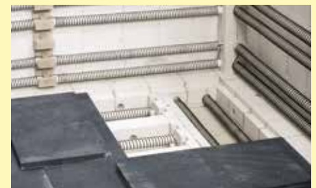
La calefacción del suelo se preserva con un revestimiento de placas de SiC (base plana para el soporte de carga).
