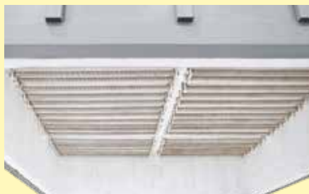
Elementos calefactores en la campana del horno
