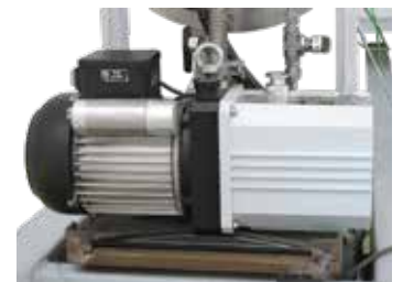
レトルトのコールド排気用の真空ポンプ
