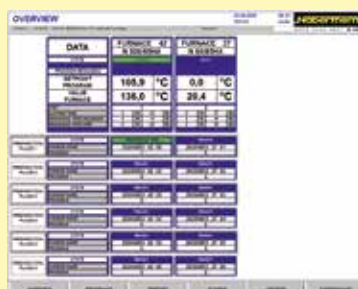
Vista general de la instalación
