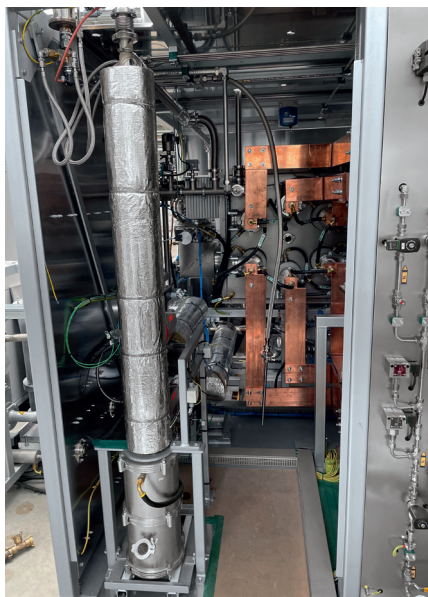
Beheizter Abgasstrang mit Binderfalle
